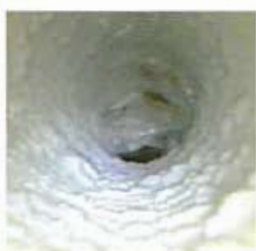
Ακάθαρτος, εύκαμπτος αγωγός προσαγωγής αέρα σε νοσοκομείο
