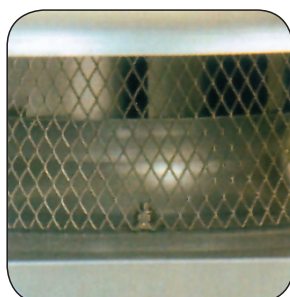
Ατσάλινο προστατευτικό πλέγμα
