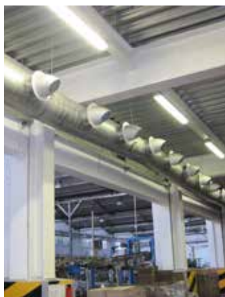
CI-300 Boca de impulsión
