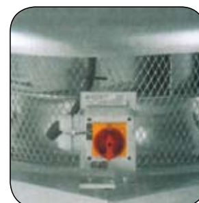
Διακόπτης ON/OFF πάνω στον εξαεριστήρα
